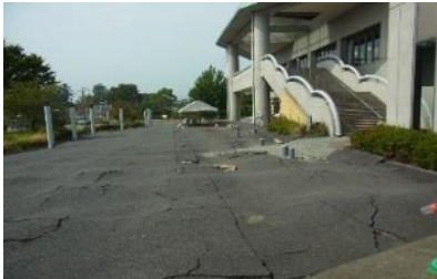
前震でひび割れ、本震で隆起し凸凹になった体育館玄関付近の様子
