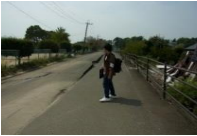
激しく隆起した道路を見つめる学生
